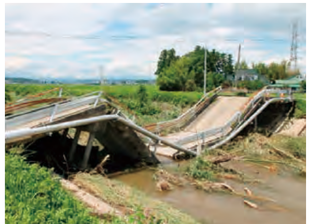
橋梁被災状況 (宮城県大崎市)
