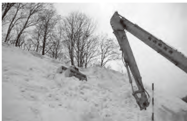
写真2 作業中バケットが外れた状況
