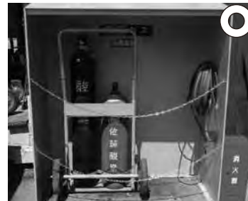
台車保管状況 2
