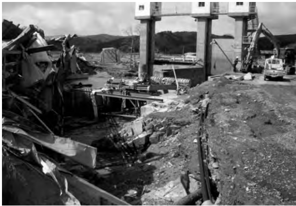
写真－3 被災の様子（月浜第二水門）
