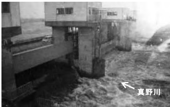
写真－5 被災の様子（真野川水門）
