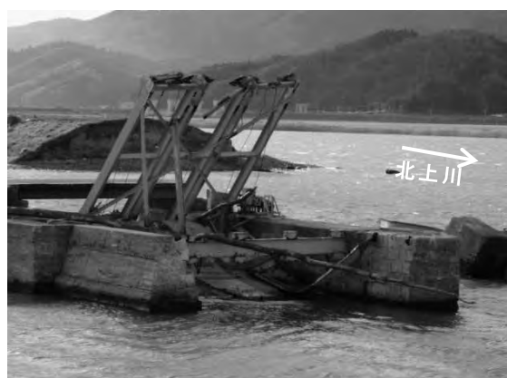
写真－1 被災の様子（釜谷水門）
