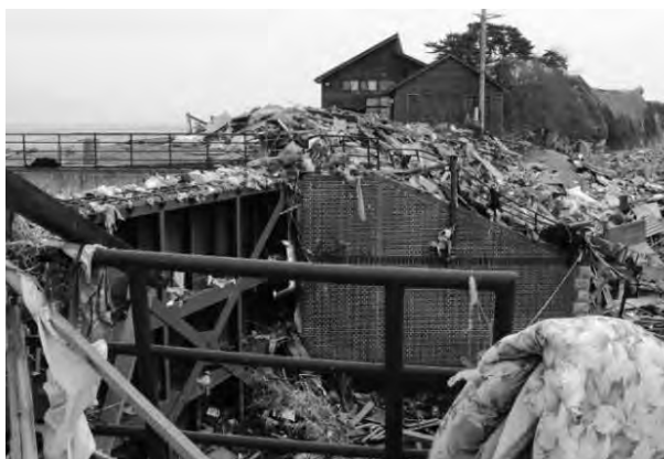
写真－8 被災の様子（野蒜水門）
