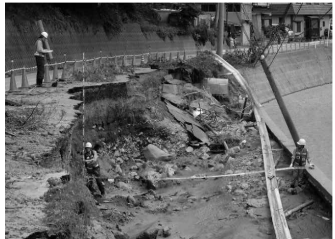
TEC-FORCEによる岩泉町道の被災状況
