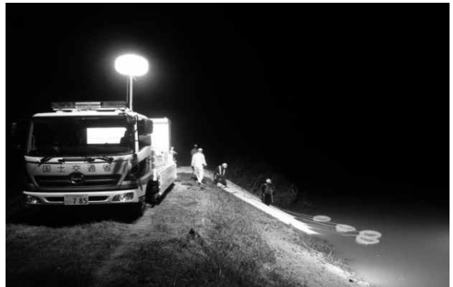
青森県七戸町での内水排除状況
