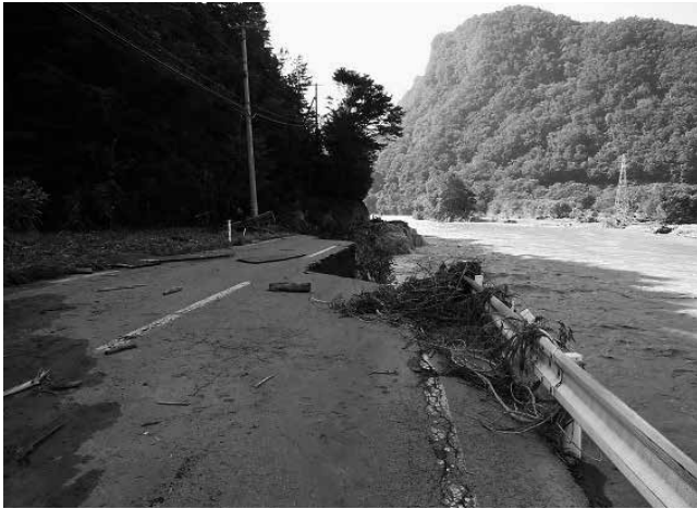
国道455号の崩落状況
