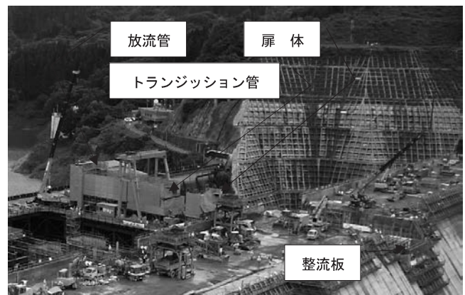
写真2 2013/6/25撮影、作業構台上の組立状況 灰色のシートで覆っているのは溶接の風除け
