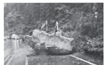
▲H15.5.26 現道における法面崩落災害
