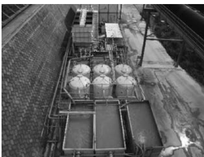
写真－７ 濁水処理設備（砂ろ過器）
