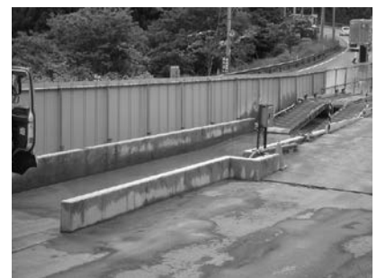
写真－９ タイヤ洗浄設備（湿式+乾式）
