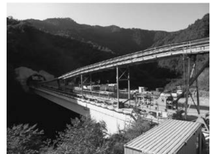
写真－1 連続ベルコン（坑口前状況）
