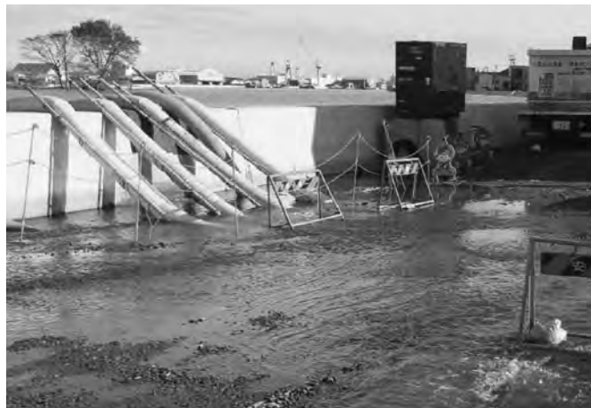
写真-3 大潮排水状況 (石巻市門脇地区)
