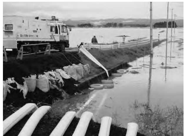
写真-2 出水排水状況 (岩沼市藤曽根地区)
