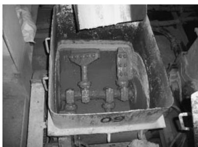
写真－3 二次圧送ポンプ
