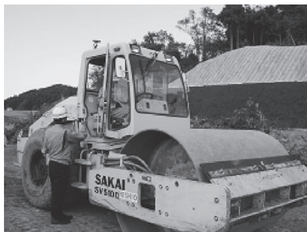
実機キャビン天井にGPSアンテナ
