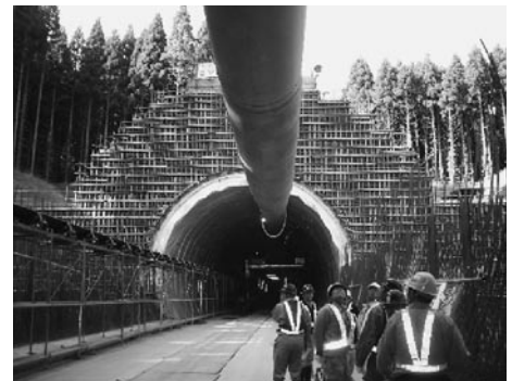
写真－６ 発進坑口の型枠残置状況
