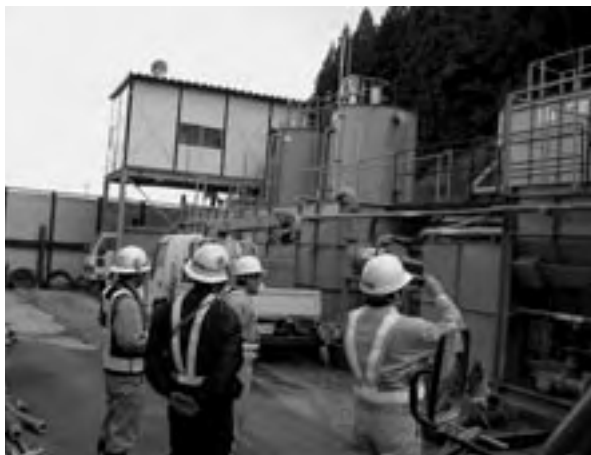
濁水処理設備（砂濾過槽：奥手前の丸タンク）
