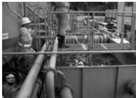
濾過槽（モールコード）
