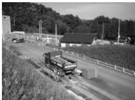
タイヤ洗浄設備
