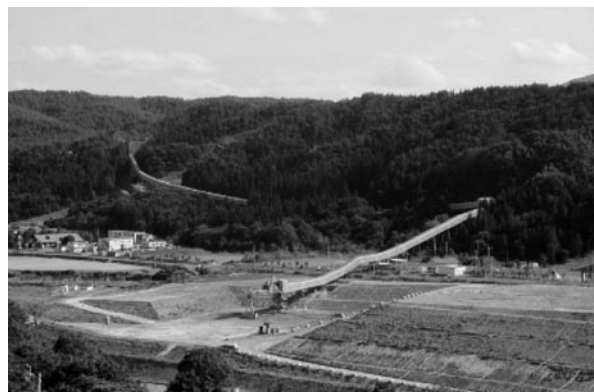
コンベヤルート（トリッパ側より）
