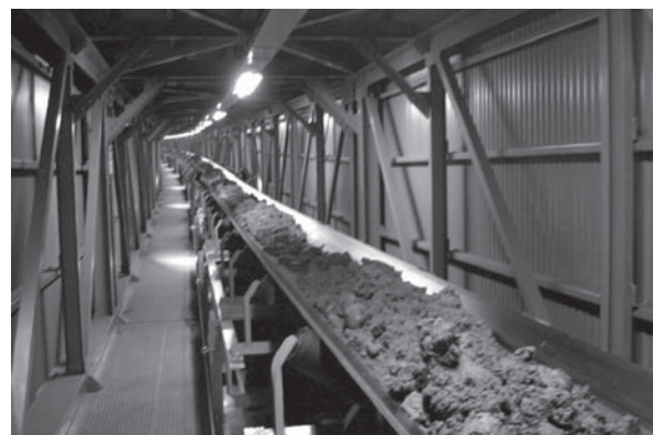
BC1コンベヤ内部
